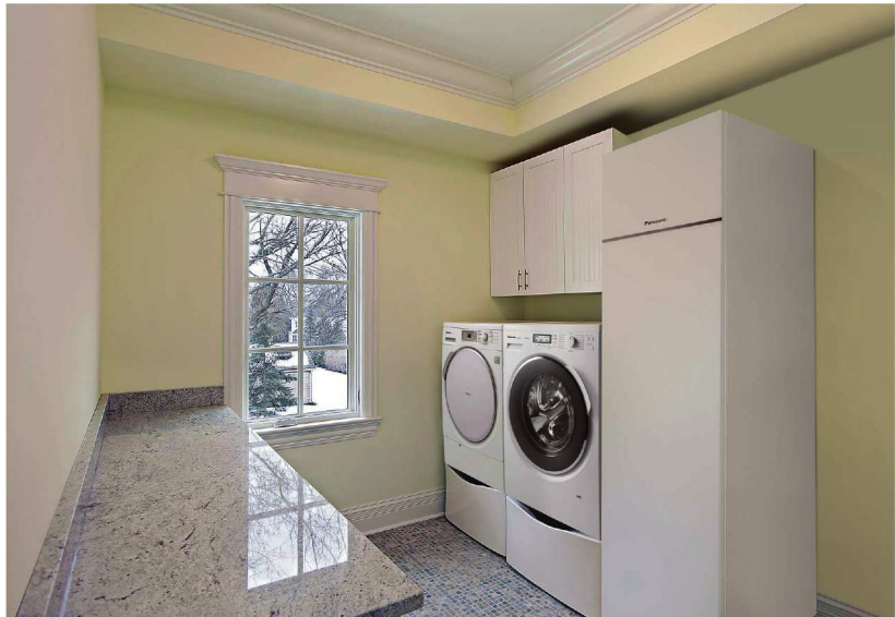
Kompakt-Wärmepumpen benötigen nicht zwingend einen Heizraum und können im Haus zum Beispiel in einem Hauswirtschaftsraum aufgestellt werden. Bild: Panasonic
