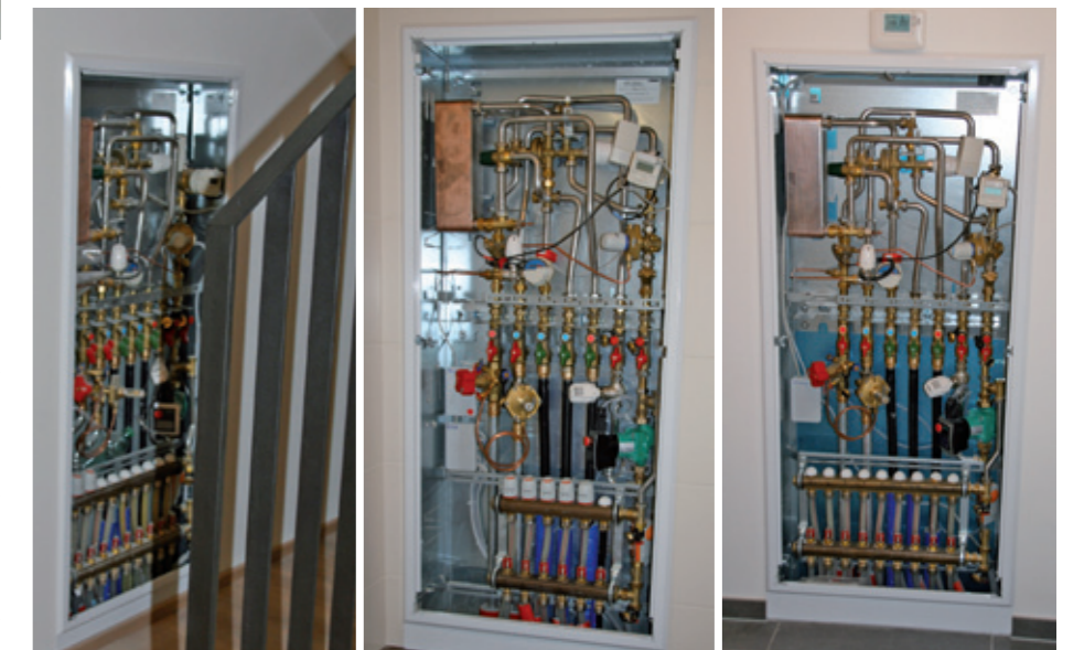
Die HERZ Wohnungsübergabestationen punkten bei Anlagenbauer und Bauträgern durch ihr überzeugendes Leistungspaket. Die Bilder dokumentieren, wie individuell die Verbauelemente im Objekt Wienerstraße gelöst wurden.
